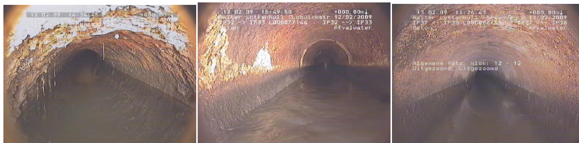
Figuur 4: Camerabeelden genomen op een afstand van ong. 150, 850 en 1250 m van de uitstroom van persleiding Grote Lijkstraat in Aalter.
